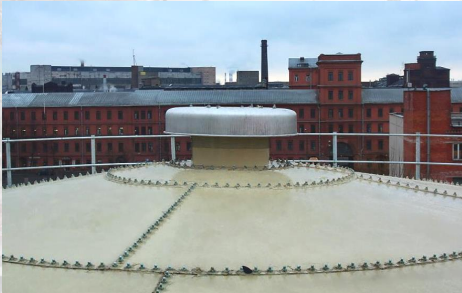
Hongo de Ventilación
